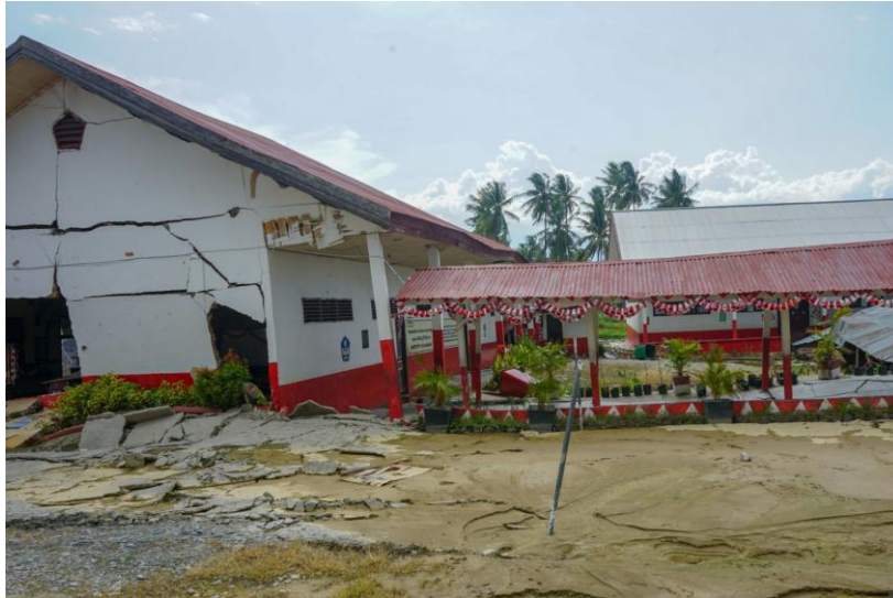
Bangunan sekolah yang rusak akibat gempa di Sulteng. (Issak Ramdhani/JawaPos.com)
